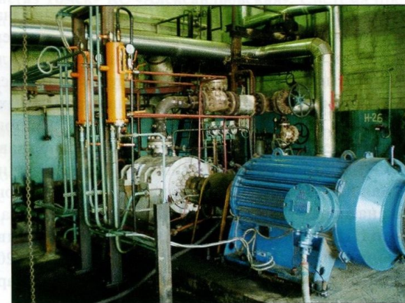
Рис. 2. Насосный агрегат АНМФ 200-600 на установке ТК-4
