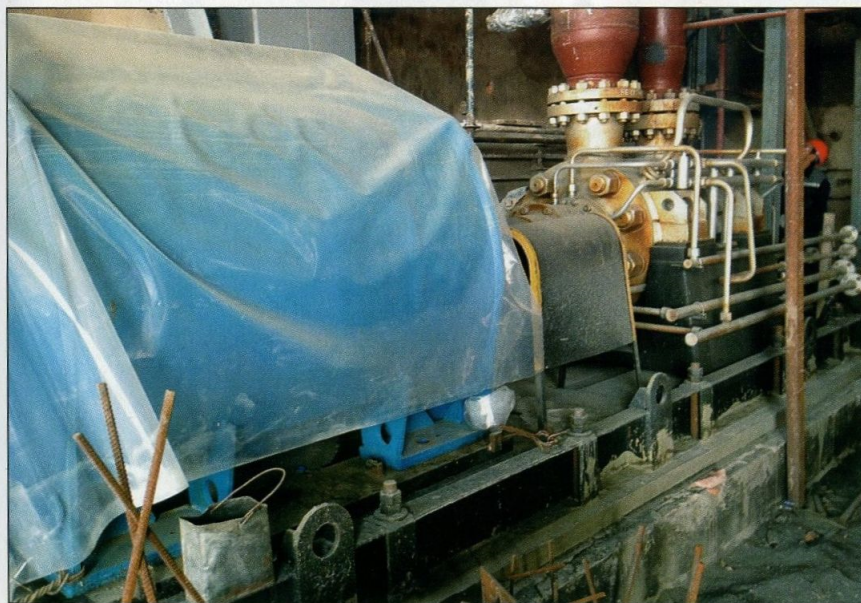
Рис. 9. Насосный агрегат АНДМс 350-600 на объекте
